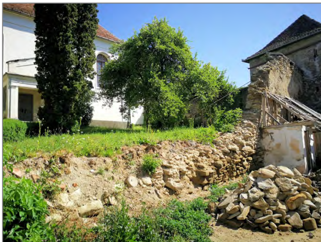
Eingestürzte Ringmauer zum Schulhof.
